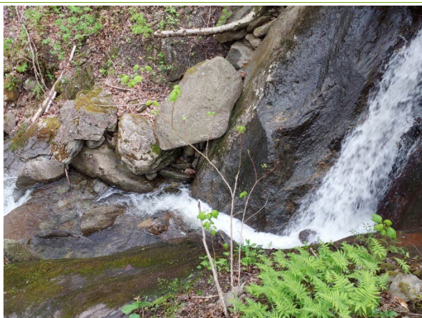
FIGURE 3 : IMPORTANTE CHUTE AU PIED DU PONCEAU TÉMOIN DU CHEMIN RÉAL (CÔTÉ NORD)
